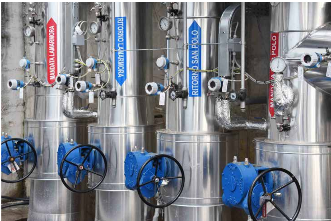
Particolare dell'impianto recupero calore
