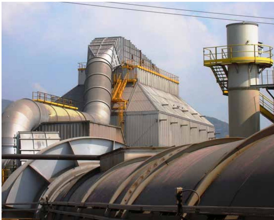
Impianti a presidio delle emissioni in aria
